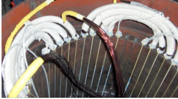
Resim 2.12: Stator iletkenlerine makaron geirilmesi
